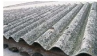
Toiture en amiante-ciment
